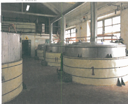
Le antiche caldaie dotate di moderni aspiratori per il vapore d'acqua
